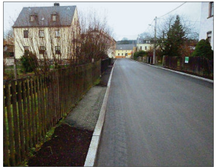
Entstanden ist auf der Brotenfelder Straße eine komplett neue Fahrbahn mit Bordbegrenzung zur Oberflächenwasserführung.
